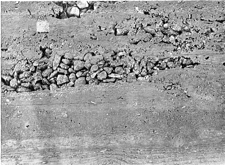
Fig. 39. Stenrederi en dårligt udført betonkonstruktion.
